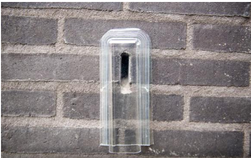
Exclusion flap. Vleermuizen kunnen er wel door naar buiten vliegen, maar niet meer terug naar binnen.
