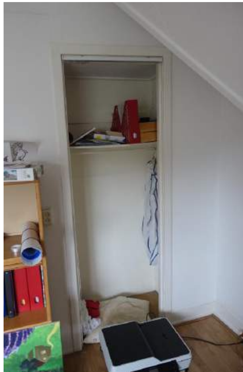
De oude inbouwkast in de voorste slaapkamer.
