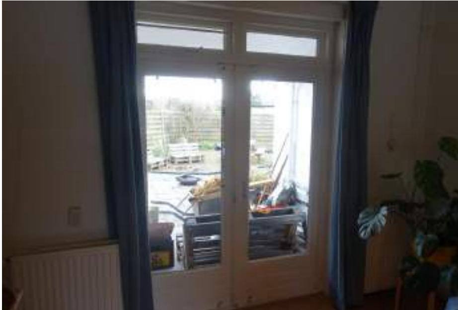
De terrasdeuren in de achtergevel zijn ooit vernieuwd binnen de oude kozijnen.
