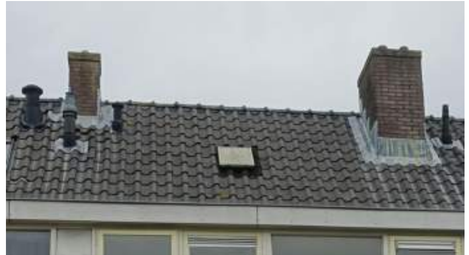
Oude en nieuwe ontluuchtingskanalen in de daken van Patijnlaan 11-13.
