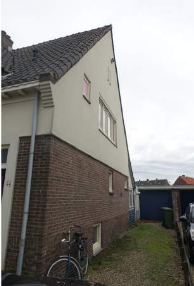
De deels gepleisterde zijgevel. Op de achtergrond de jonge garage die de oprit afsluit
