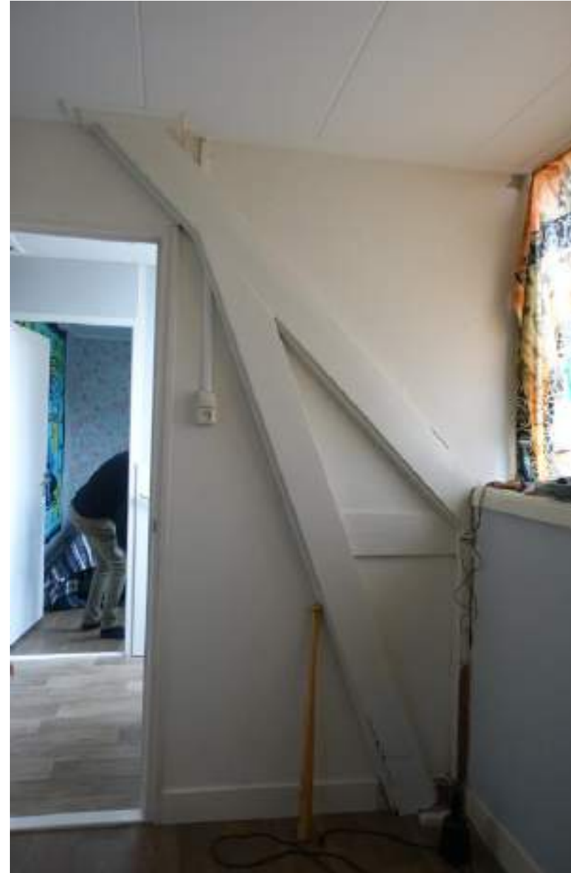
Spant met kreupele stijl in woning Dijnselweg 47.
