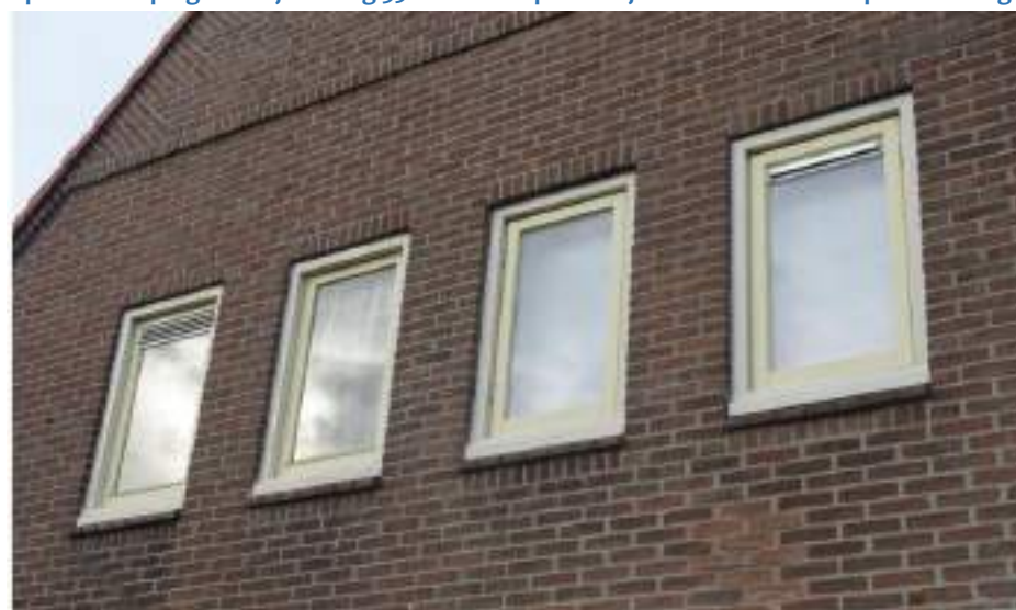
De meeste vensters hebben in 1966 nieuwe lekdorpelstenen gekregen, zoals hier bij Dijnselweg 45-47.
