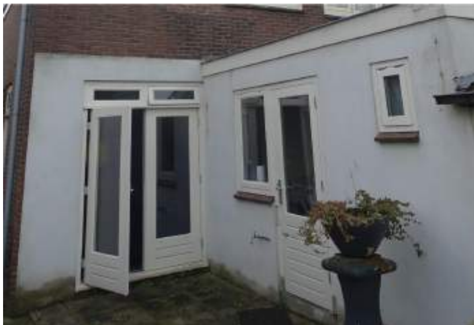
De doorgangen in de achtergevel en in de gevel van de oorspronkelijke uitbouw zijn nog oud. Alle vensters zijn later toegevoegd, net als de vullingen in alle openingen.
